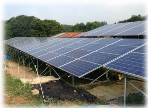
あさひ発電所ソーラーパネル完成 8/5
